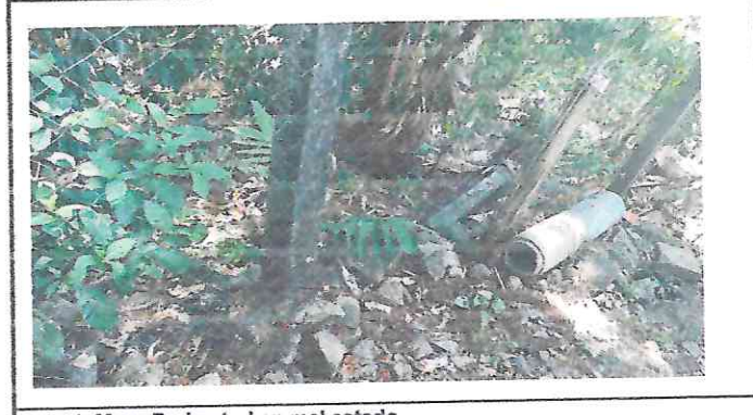
Foto 4: Muro Perimetral en mal estado.
