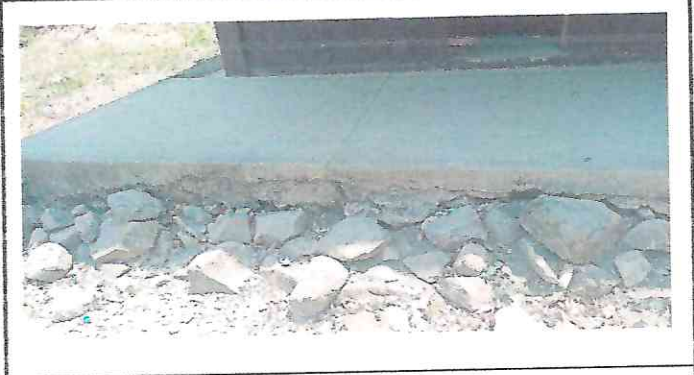
Foto 2: Banquetas en mal estado.
