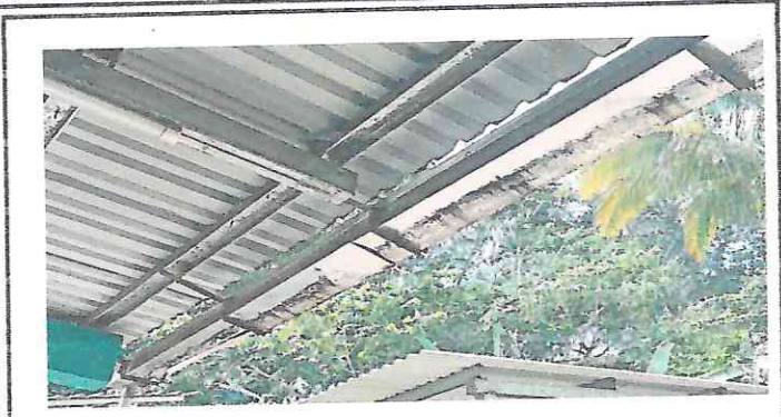
Foto 1: Canales de agua deteriorados por las lluvias.
